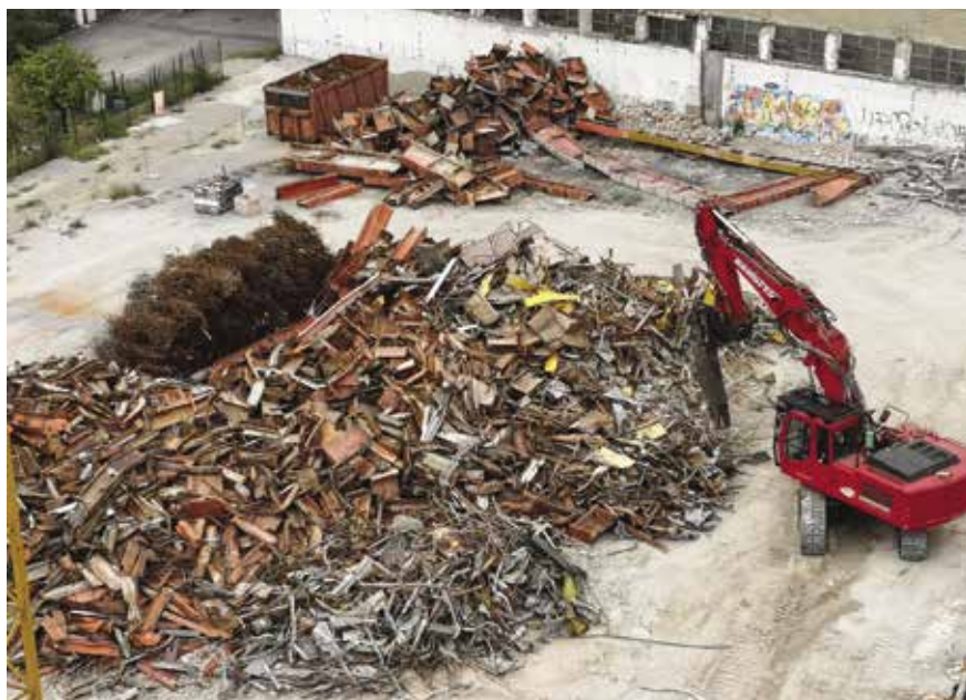
↑ TAGLIO DEI ROTTAMI DI FERRO SUL PIAZZALE DEL CANTIERE TRAMITE CESOIA OLEODINAMICA ED ESCAVATORE
