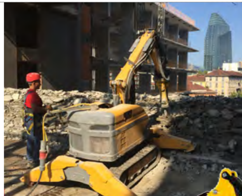
Leggero e potente il Brokk 160 lavora per Armofer in copertura di un edificio in Milano centro. E' equipaggiato con il martello idraulico per demolire parzialmente il solaio
