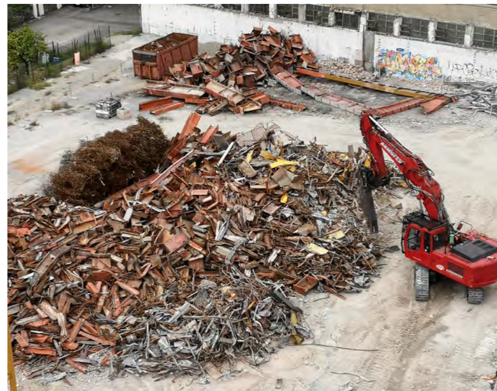
► Taglio dei rottami di ferro sul piazzale del cantiere con cesoia oleodinamica ed escavatore
